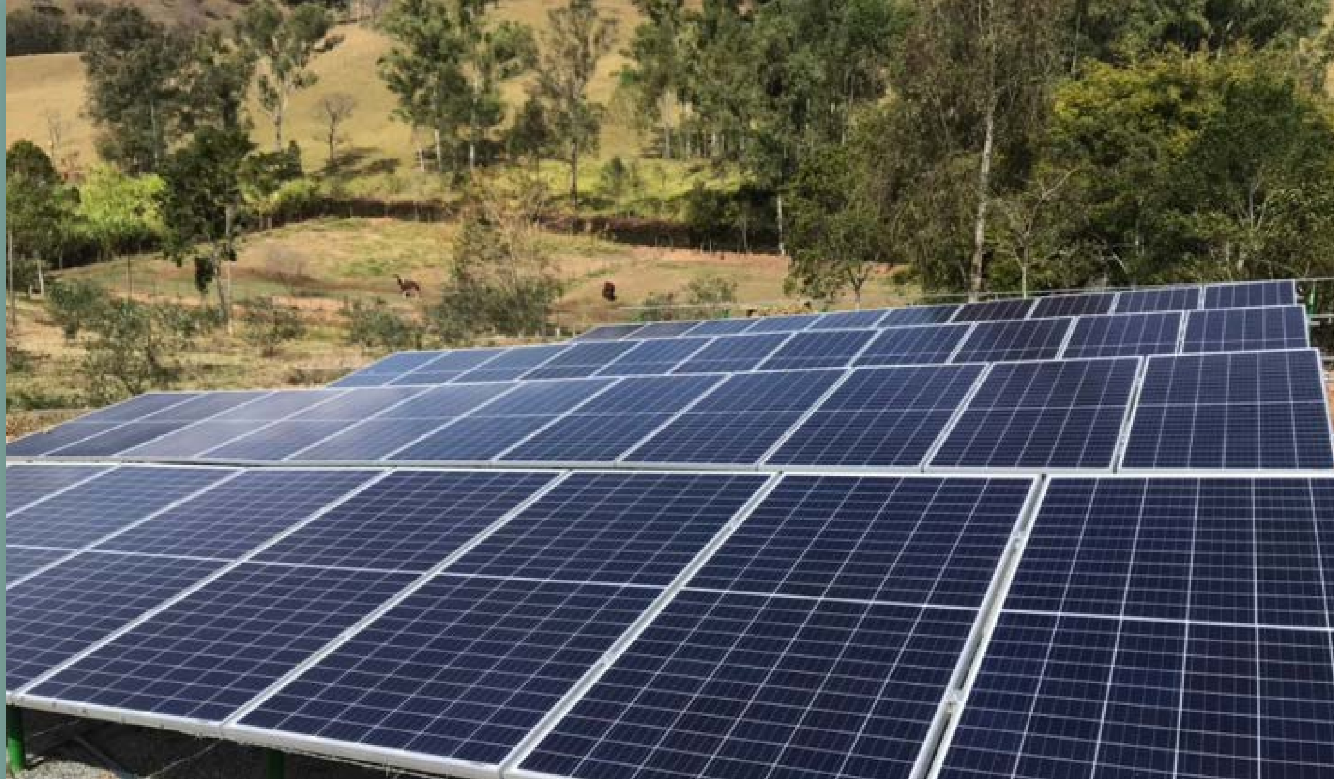
SISTEMA FOTOVOLTÁICO (Gerador de Energia)
